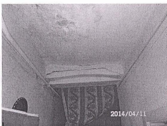
Beázás és repedés
